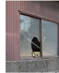
窓が割れた 管理不全空家
