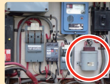
低圧分電盤内の低圧コンデンサー
