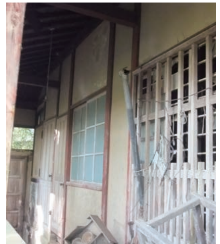
老朽化した空き家
