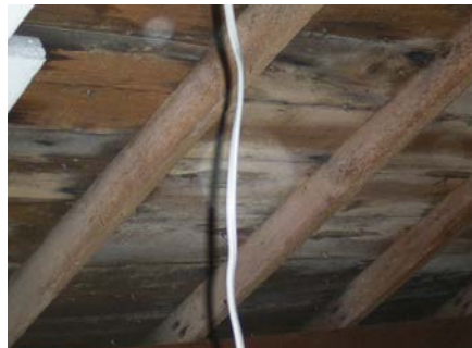
屋根下地である野地板にカビが発生している。 小屋裏の通気が不十分と考えられる
