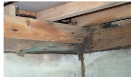
「蟻道」の写真。基礎のコーナー部分に土の盛り上がりが見られる。 土台は食害を受けている状態
