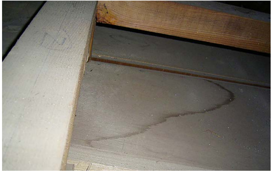
天井の裏面に見られた雨漏り跡。もしこのような水染みを見つけたら、直上の野地板、垂木を確認するとよい
