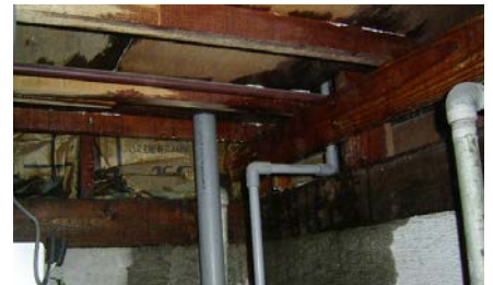
洗濯機置場から水道水が床下に漏れている状態。雨漏り以外に設備配管等からの漏水の可能性もある
