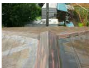
劣化が進行している屋根
