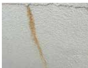
鉄筋の錆び汁を伴う亀裂が見られる外壁(コンクリートブロック積下地モルタル塗り部分)
