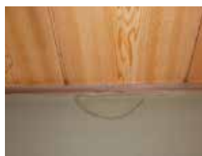
天井部分に見られる雨漏り
