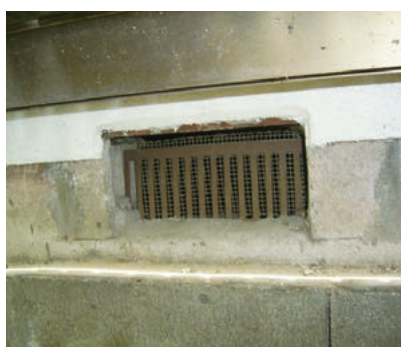
床下換気孔は基礎の一部を欠いて設けられるため、ひび割れが周囲に生じることもある
