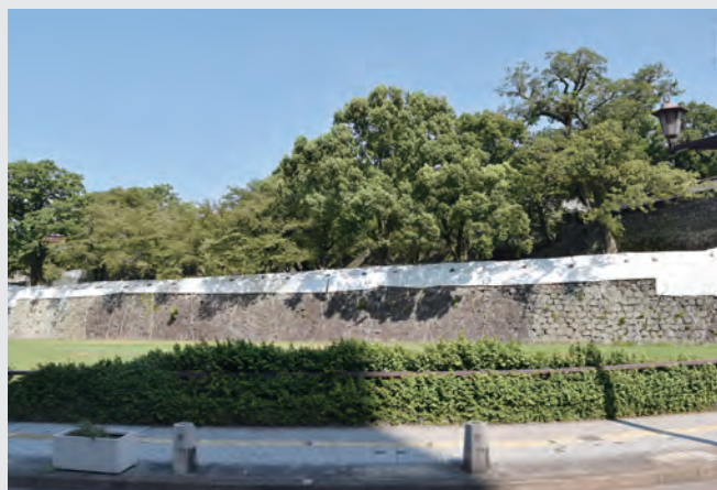
熊本城の石垣の一部にも被害(熊本県熊本市)
