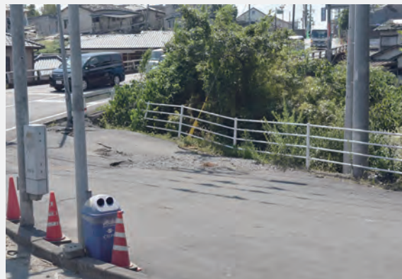
道路に入った亀裂(熊本県益城町)
