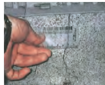
基礎のひび割れ幅の計測
