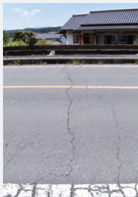
道路に入った亀裂(熊本県西原村)
