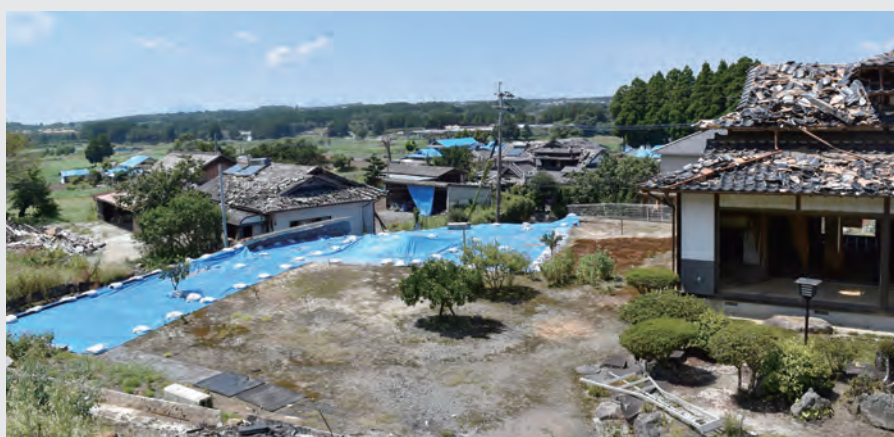
一部が崩落した擁壁(熊本県西原村)
