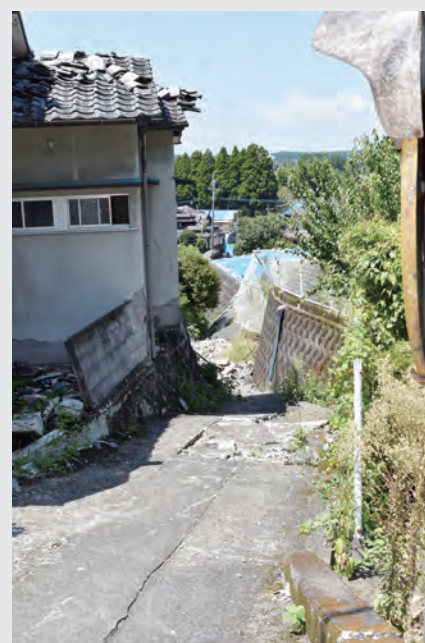
一部が崩落した擁壁(熊本県西原村)
