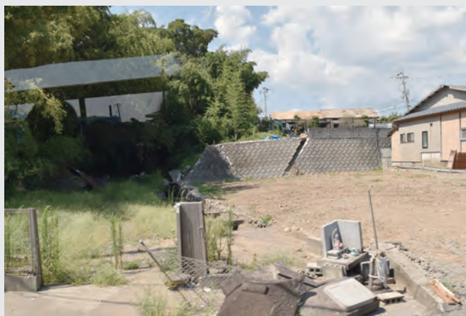
擁壁に入った亀裂(熊本県益城町)
