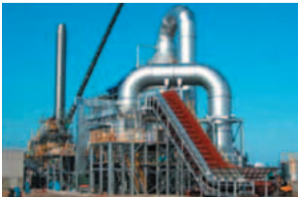
仙台市設置仮設焼却炉
