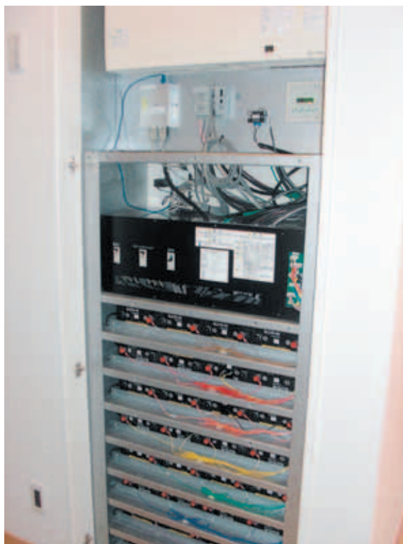
「グリーンファースト ハイブリッド」に搭載されている鉛式の蓄電池。大容量の蓄電ができるのが特徴だ。災害時の貴重な電源としても機能する
