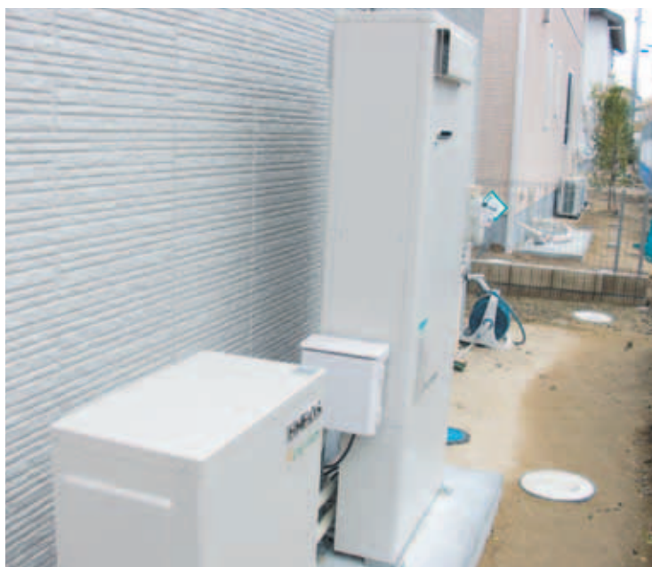
家庭用燃料電池「エネファーム」はガスでお湯をつくり発電する仕組み。補助金制度があることで近年、普及が進みつつある(スマートコモンシティ明石台)
