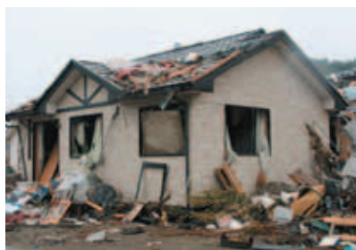
東日本大震災で被災した家屋（東松島市）
