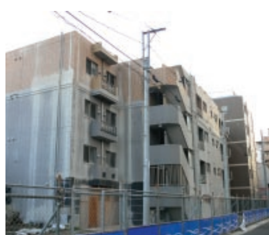
倒壊の危険から上階部分が取り壊されている「GS藤沢」。2年後の竣工を目指し、解体後9月から着工する
